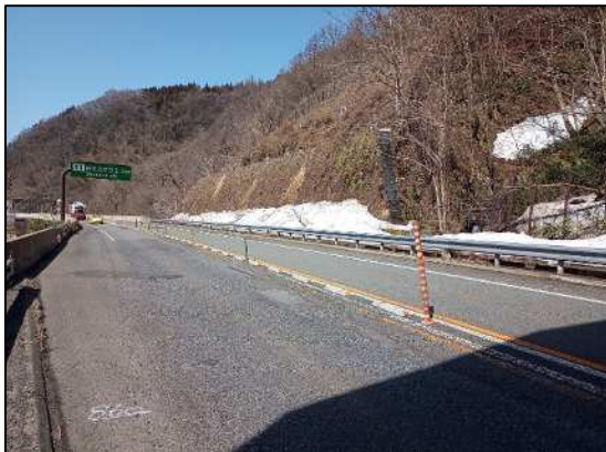
舗装損傷写真
